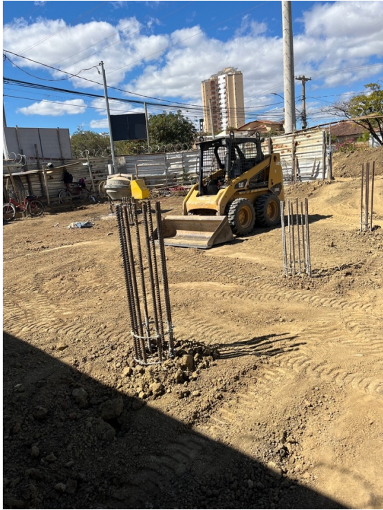
Regularização do terreno e limpeza no entorno da obra. Empresa: Turano Construtora.
