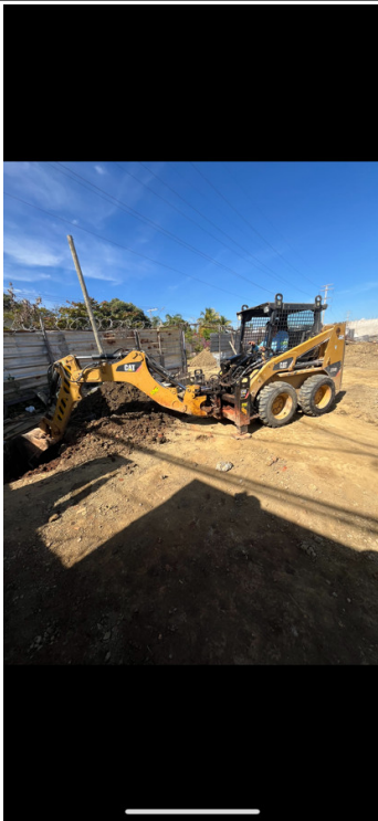
Escavação e concretagem das sapatas e pescoços de pilares da fundação. Empresa: Logaste Construtora, Turano Construtora.
