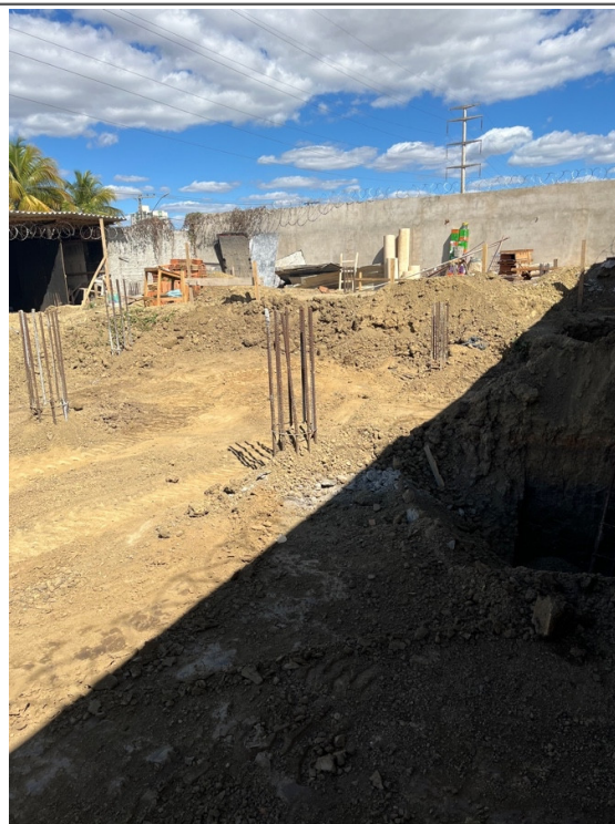
Regularização do terreno e limpeza no entorno da obr Empresa: Turano Construtora.
