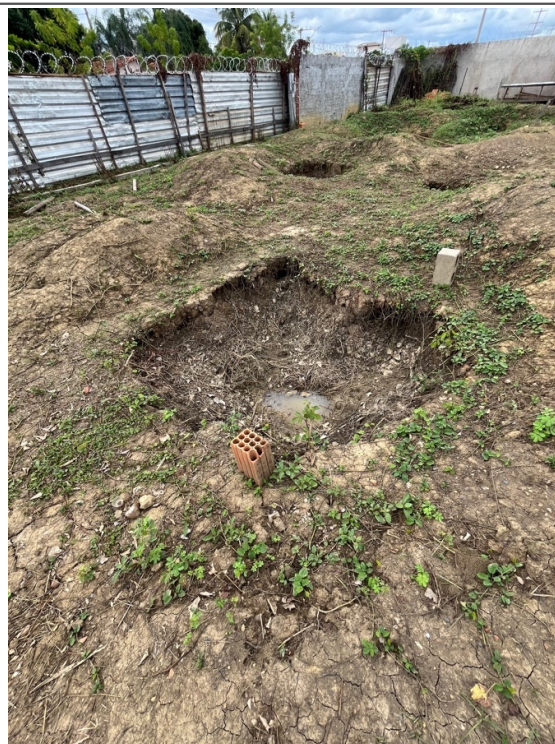
Escavação e concretagem das sapatas e pescoços de pilares da fundação. Empresa: Logaste Construtora, Turano Construtora.
